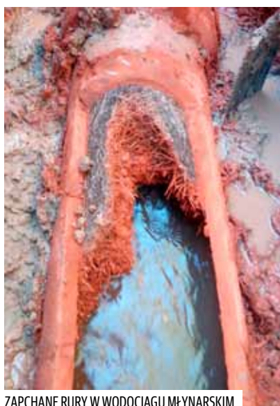
ZAPCHANE RURY W WODOCIĄGU MŁYNARSKIM
